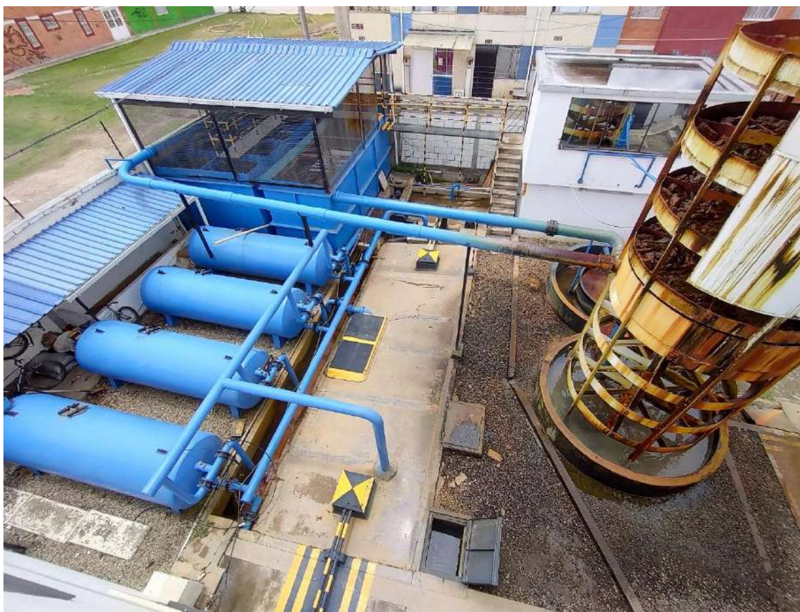
Tanque Floculador y Sedimentador – PTAP
