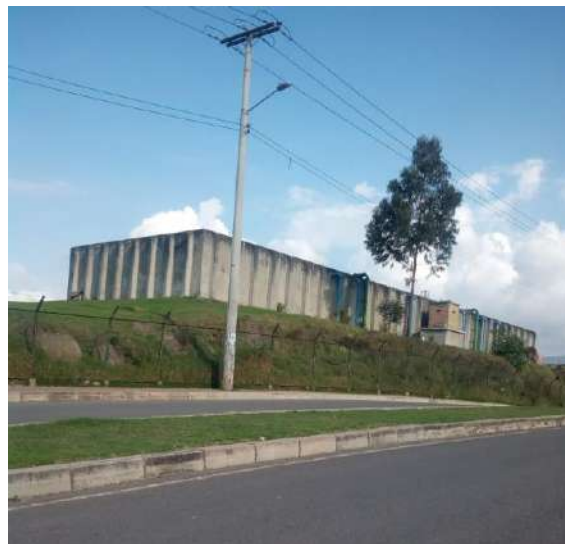
Tanque de almacenamiento del Acueducto – Urbanización Quintas de Santa Ana.
