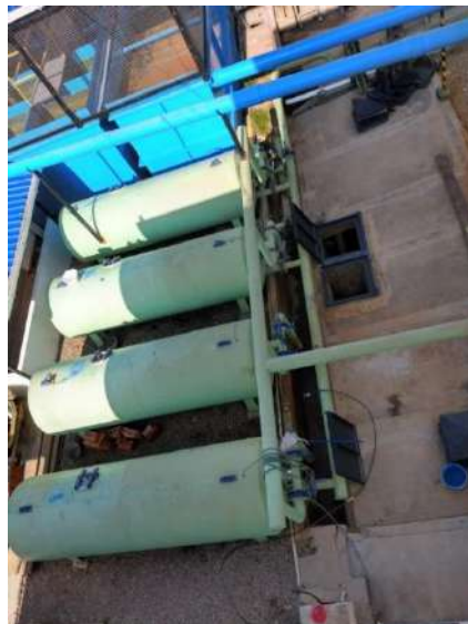
Batería de filtros – PTAP
