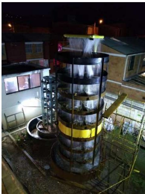
Torre de Aireación – PTAP
